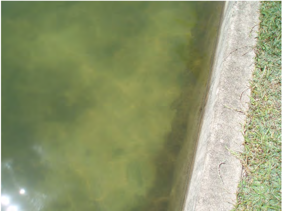
Figure 2-4 No rock scour protection at toe of wall 38 Saltwater Av
